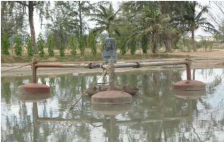
บ่อให้อากาศ 1 ~บำบัดน้ำเสีย 5,000 ลบม./วัน ก่อนใช้ ฟิโก
